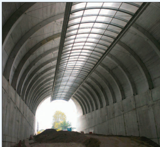
9. L'illuminazione è realizzata con apparecchi a LED in conformità a quanto previsto per tutti gli impianti di illuminazione pubblica cittadina dal Comune di Milano
